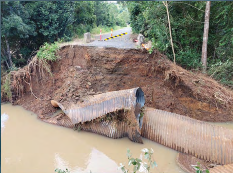
Keerrong Rd: Culvert washout
